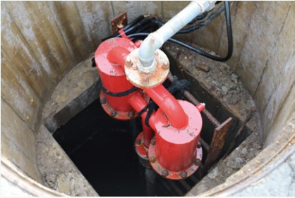
图注：雨水收集园区绿色滴灌项目
