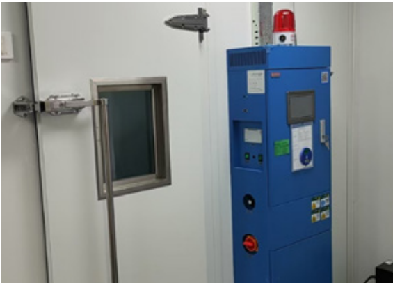
5.5kw 步入式实验室实现升级改造，每年可节约 5.5 万度电
